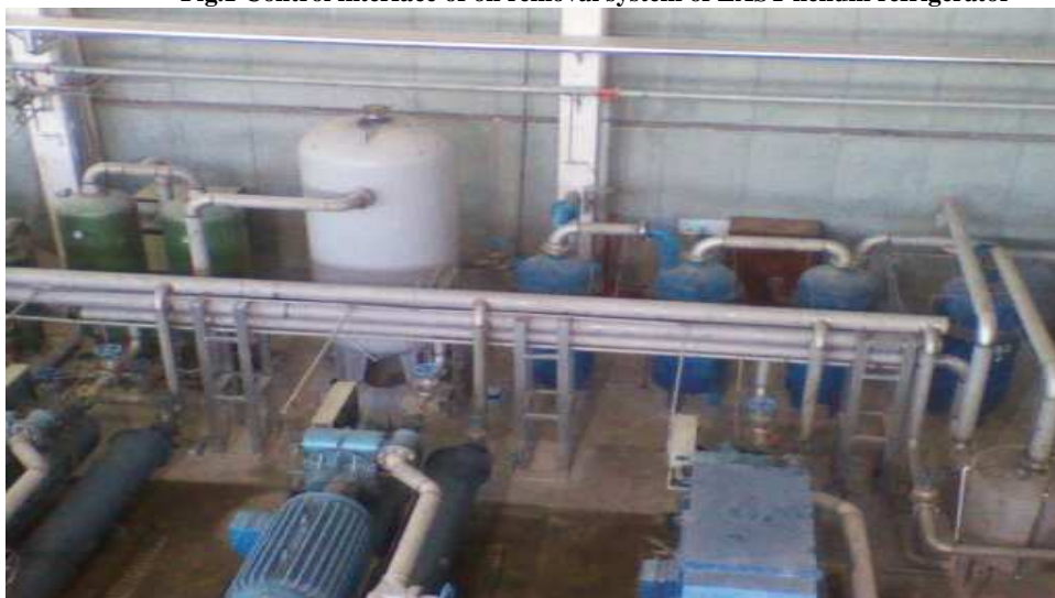
图 2 EAST 氦制冷机除油系统
